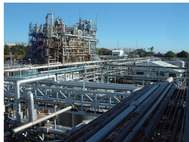
蒸気配管、工場の敷地
