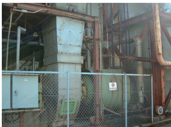
一次空気口全景(ボイラー)
